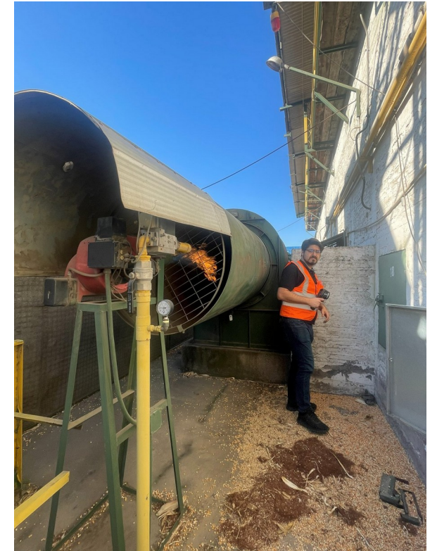
Quemador y ducto de entrada de aire
